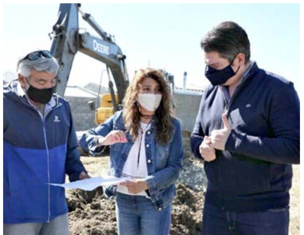
El intendente Martín Pérez, junto al concejal Pablo Llanapani, presenció el inicio de la construcción del Gimnasio Municipal de Deportes de Contacto, una de las principales obras de cara al centenario.
