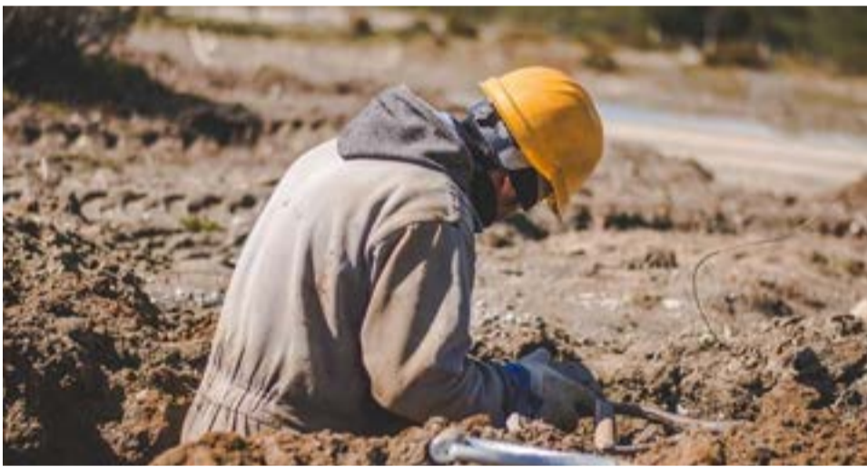
“Ya se inició la excavación de pre tendido subterráneo del cableado para la iluminación ornamental, la puesta tierra de columnas de alumbrado y artefactos eléctricos”, afirmó Muñiz Siccardi.
