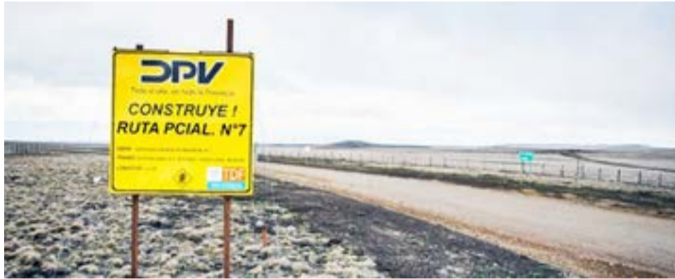
Adelantó que “se está muy cerca de poder abrir la ruta Provincial N° 7”.
