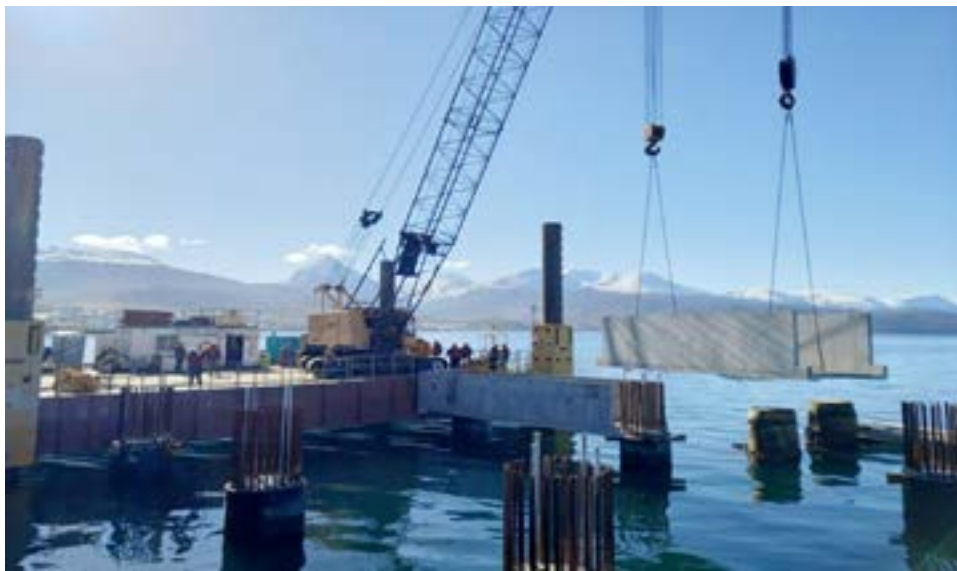
Por las deudas que se fueron acumulando, las empresas que conforman la UTE que tiene a su cargo la ampliación del puerto de Ushuaia paralizaron la obra.
