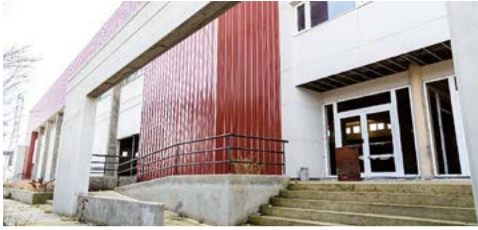
La ministra de Obras y Servicios Públicos Gabriela Castillo recorrió la obra que tendrá para su finalización un monto de inversión superior a los 123 millones 800 mil pesos.
