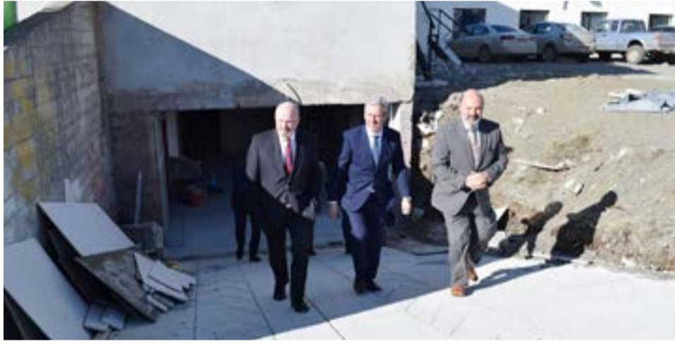
Jueces del Superior Tribunal de Justicia recorrieron la obra donde funcionarán los juzgados de Instrucción en Río Grande.
