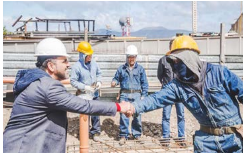
El intendente Walter Vuoto recorrió la obra del nuevo Centro de Monitoreo de Defensa Civil Municipal de la ciudad de Ushuaia.
