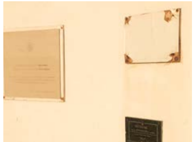
En el sector de las placas, se registró el faltante de una de ellas colocada en conmemoración del centenario de la ciudad.
