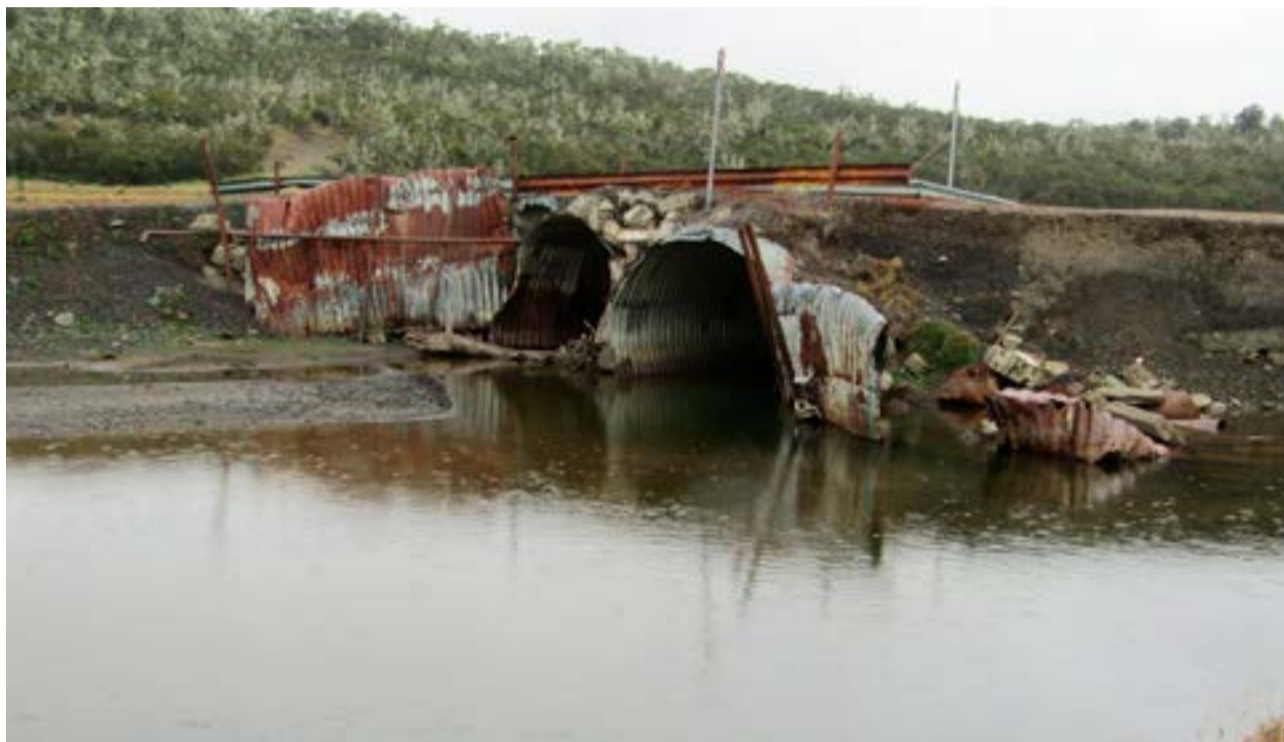
‘Gigi’ Iglesias entendió que “se debe volver a colocar un puente en Radman para vincularnos con Chile y potenciar la zona norte de la Isla”. El paso Fronterizo Bella Vista se encuentra cerrado al tránsito desde 2018 por falta de un puente.
