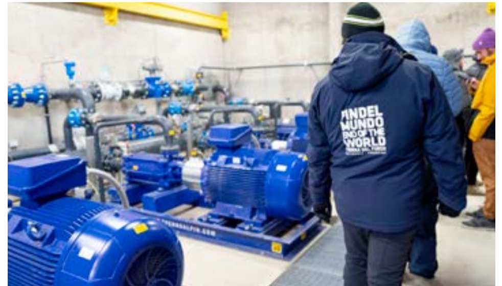
Begué informó que "este año hemos hecho una nueva sala de bombeo, pasando de tener de dos bombas a seis, lo cual mejora ampliamente la capacidad de producción de nieve".
