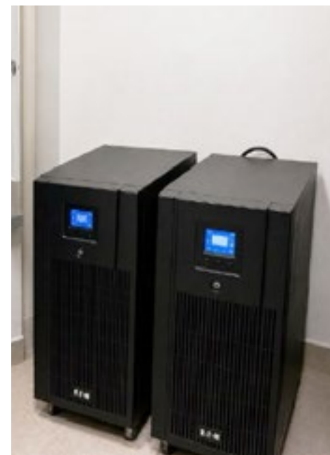
Instalan sistema eléctrico con fuente de alimentación interrumpida en la Cámara de Apelaciones de Río Grande.
